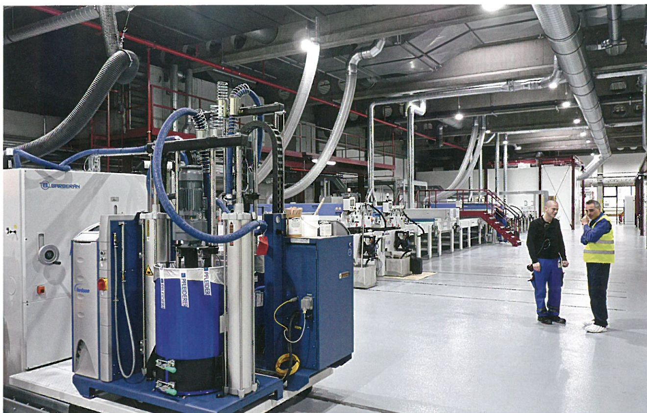
Bei Pfeleiderer in Leutkirch steht die größte „Hot Coating“-Anlage der Welt. Anfang 2018 wurde sie in Betrieb genommen
